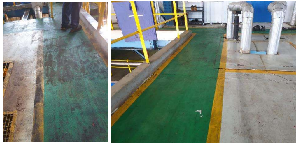
Floor Coating yang mengelupas
