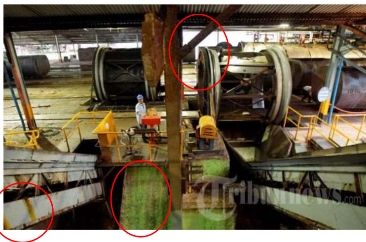
Contoh atmospheric corrosion pada steel structure
