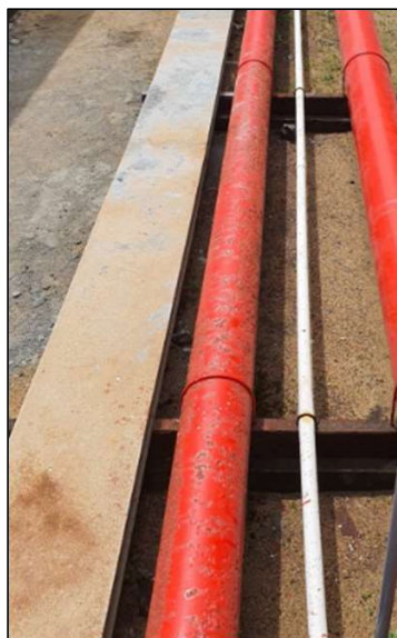
Atmospheric corrosion pada fire water pipe
